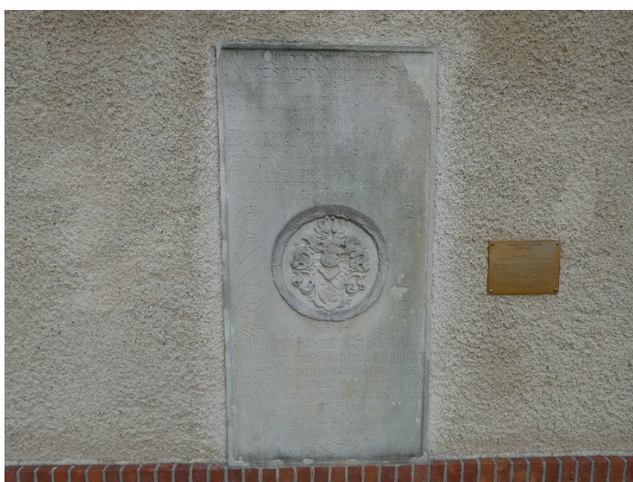
Fot. 20. Epitafium na elewacji kościoła w Trestnie
