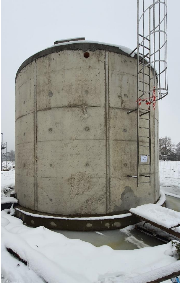
Nowy zbiornik na wodę uzdatnioną o pojemności 200 m 3
