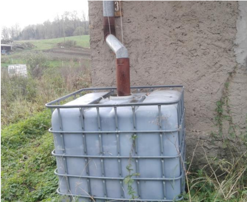
Rysunek 28. Odpływ deszczówki z dachu do szczelnego zbiornika. Pomaga to zapobiegać zwiększenia populacji komarów.
