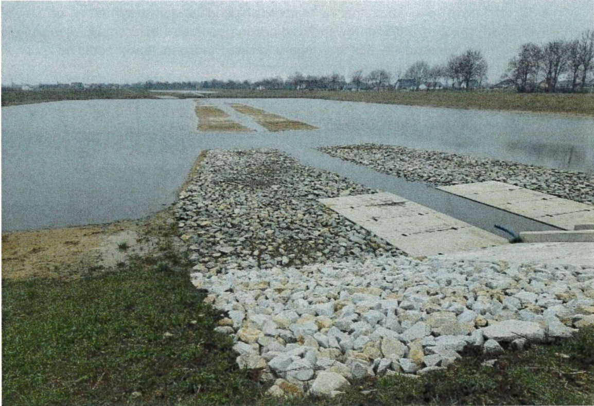
Część filtracyjna zbiornika wielofunkcyjnego w Smardzowie
