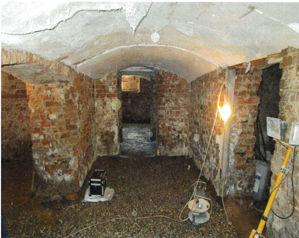
Powyższe zdjęcie obrazuje stan piwnic przed wykonaniem prac.
