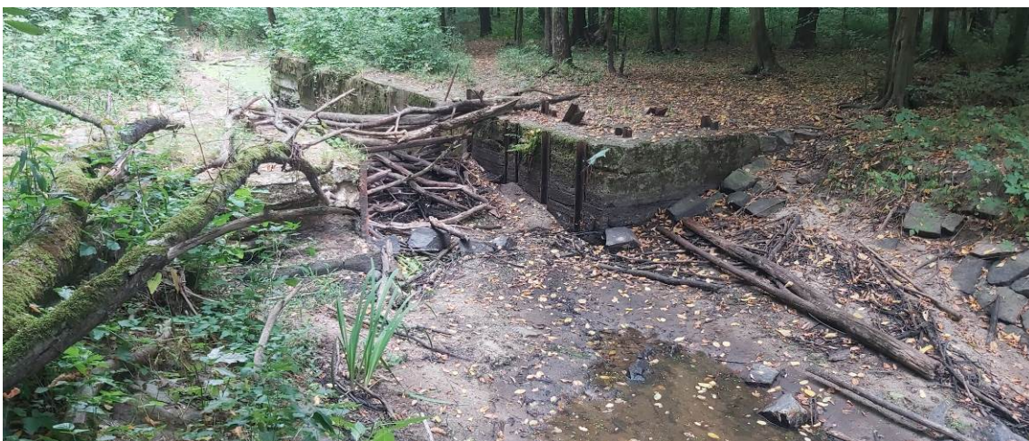
Rycina 9. Ślady dużej ilości wody na starej poniemieckiej przeprawie nad kanałem w dolinie Odry.
